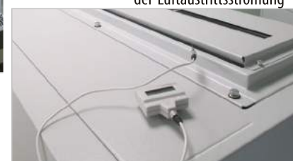
Messung der Temperatur der Luftaustrittsströmung
